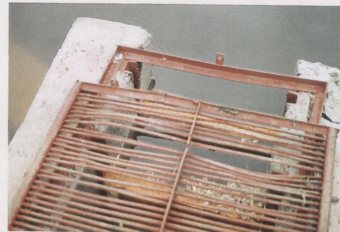
VÝPUSTNÝ OBJEKT Napuštěno na 1 chybějící dřevěnou duž
